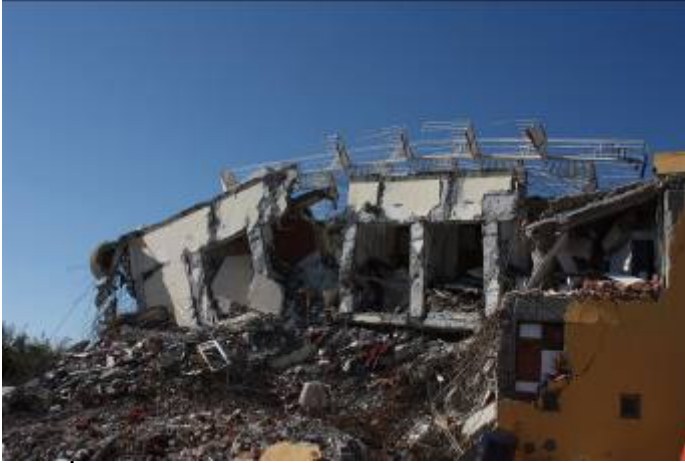
Erciş İlçesinde Yıkılan Bir Otel Binası
