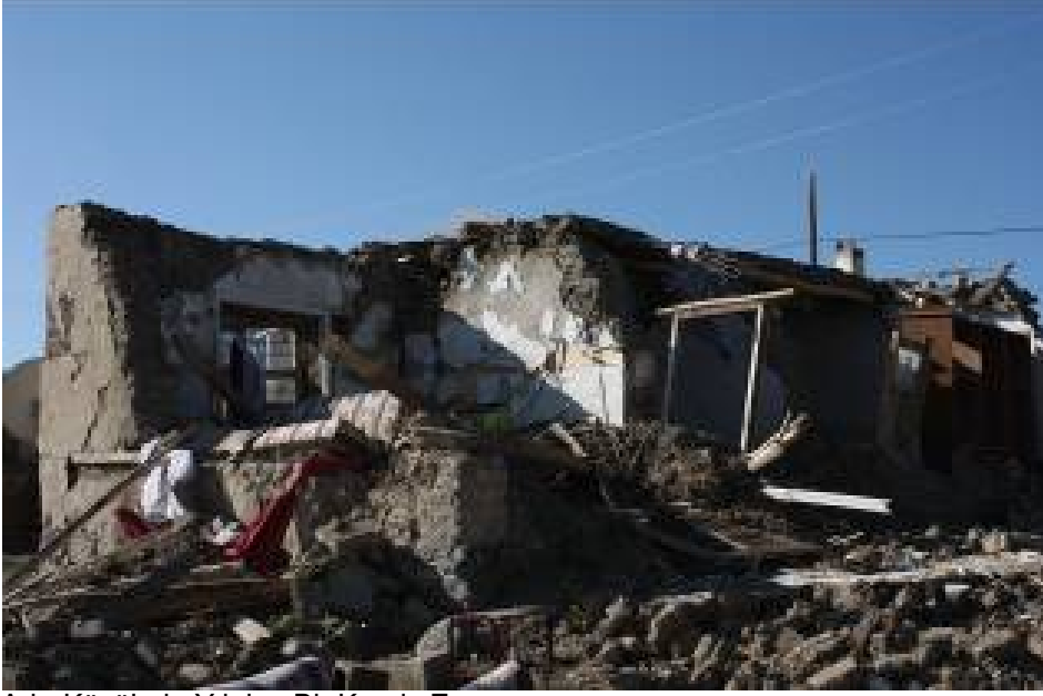
Adır Köyü'nde Yıkılan Bir Kerpiç Ev
