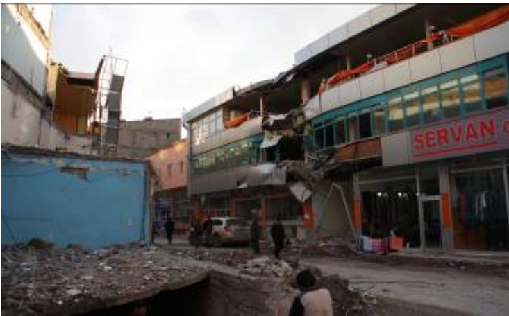
Van Merkezde Yıkılarak Devrilen Otel Binasından Hasar Gören İş Merkezi
