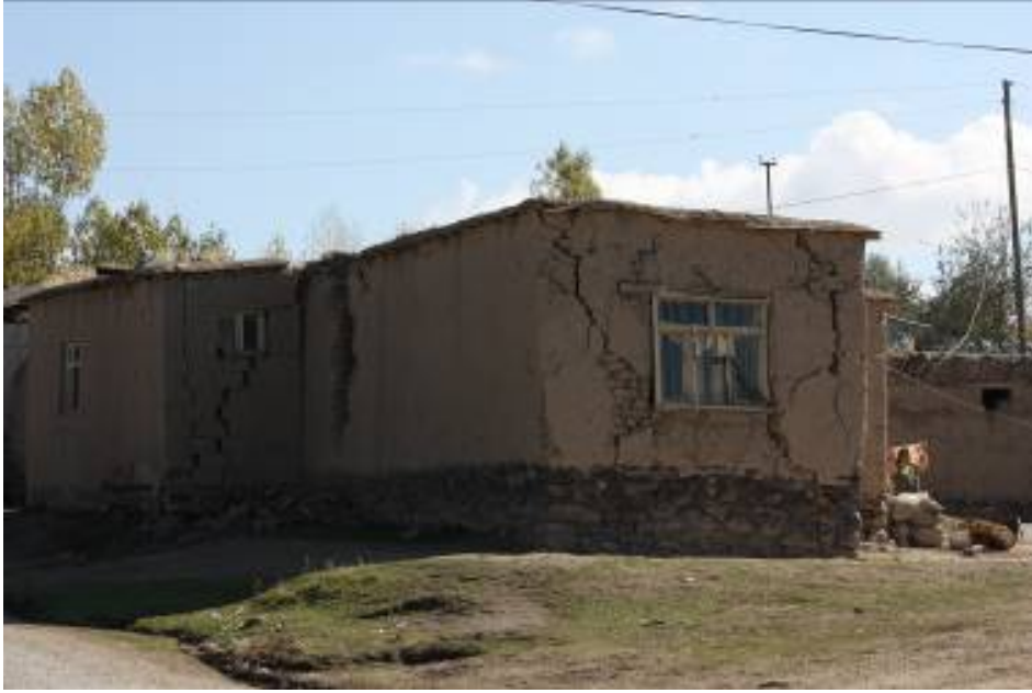
Döşeme Mezrası'nda Hasar Gören Kerpiç Ev
